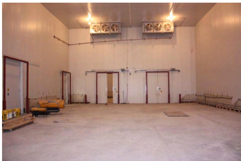
Imagen 12. Vista del equipamiento dual de refrigeración
