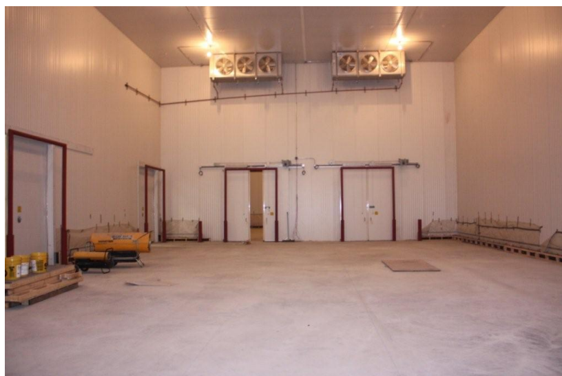
Imagen 12. Vista del equipamiento dual de refrigeración
